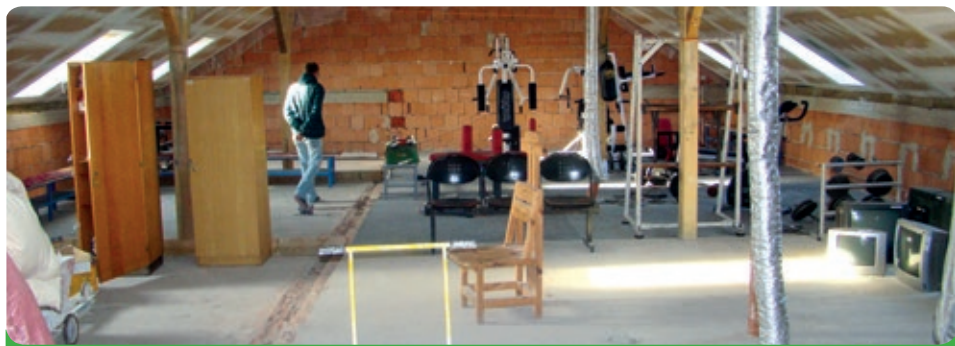
Prostory v podkroví hráčských šaten působí velmi neutěšeně a zaslouží si rekonstrukci
