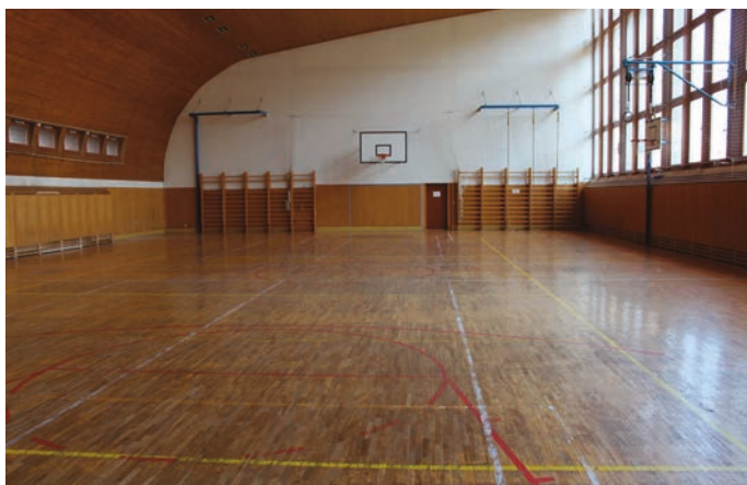
Podlaha tělocvičny před renovací
