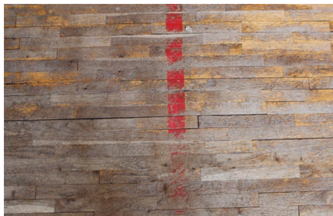
Podlaha tělocvičny před renovací
