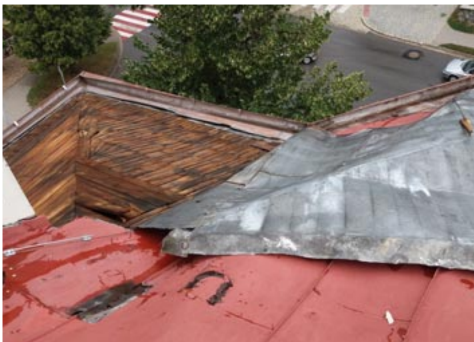
Poškozená část střechy po vichřici v r. 2019
