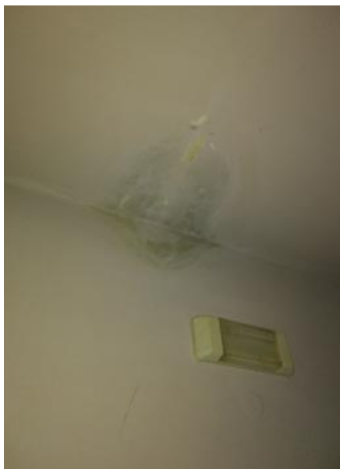
Zatékání stropem v chodbě k WC
