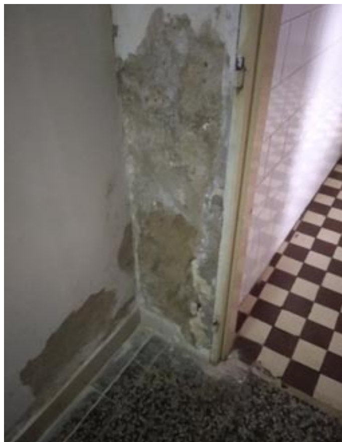
Spodní vlhkost ve zdi kuchyně
