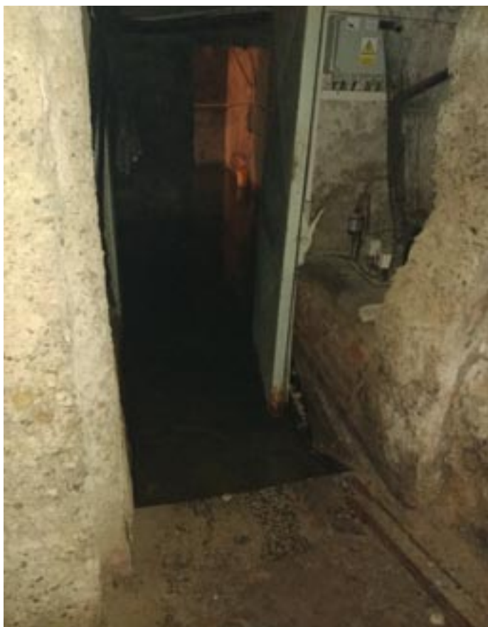
Nastoupená voda a zdevastované zdivo v místnosti sklepa
