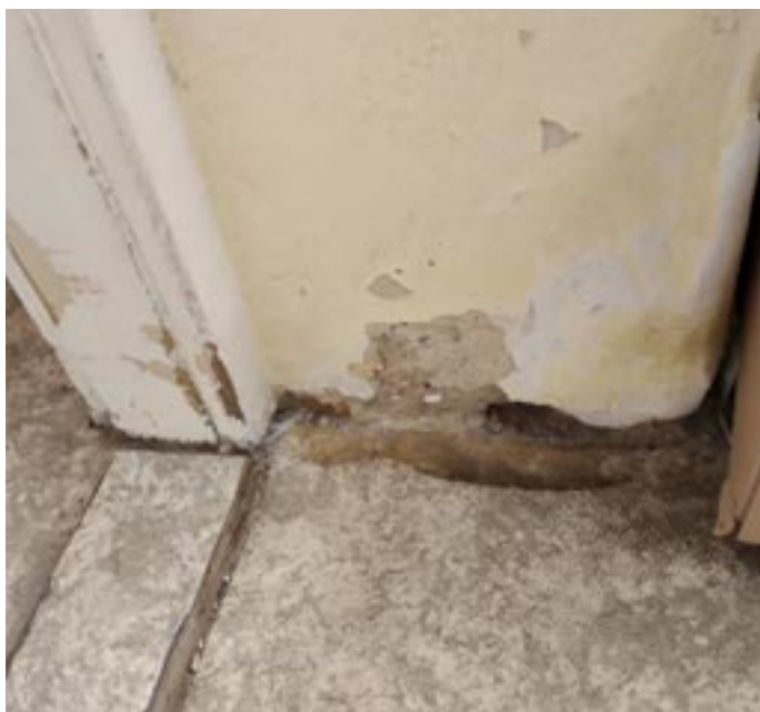
Vlhkost a plíseň v prostorách pošty.
