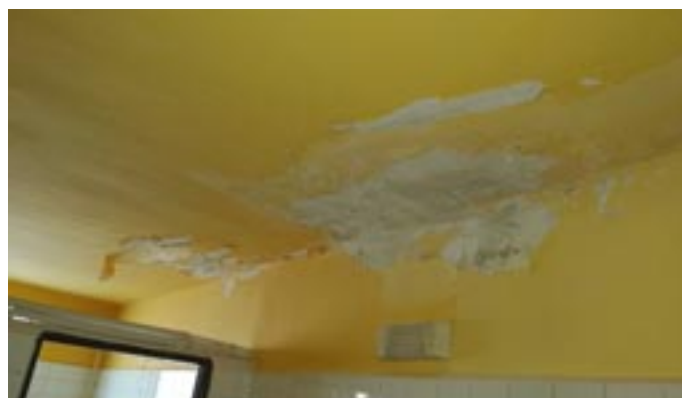
Zatékání stropní konstrukce na WC v přízemí
