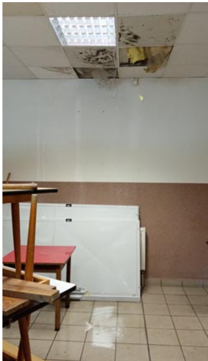
Při dešti protéká voda přes osvětlení do vnitřních prostor.
