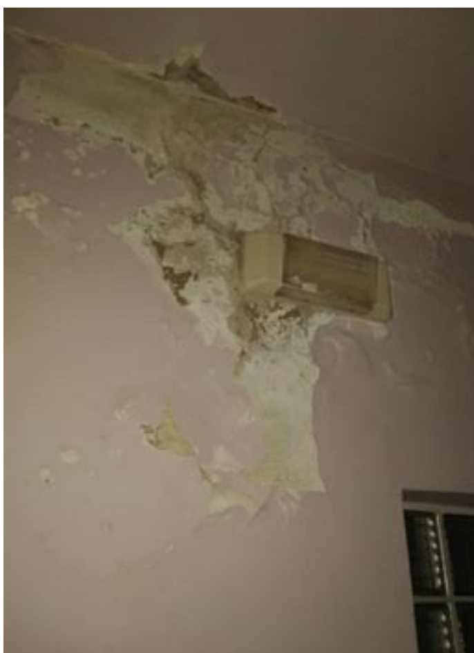
Zatékání stropem v chodbě k WC, sousedící s kuchyní
