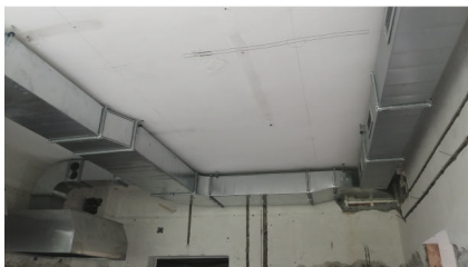
Zatékání do střechy
