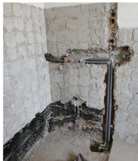
Rozvody vody v kuchyničke v 1NP
