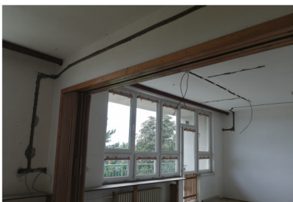
Elektroinstalace ve třídách
