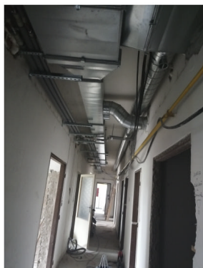
Rozvody vzduchotechniky v chodbě
